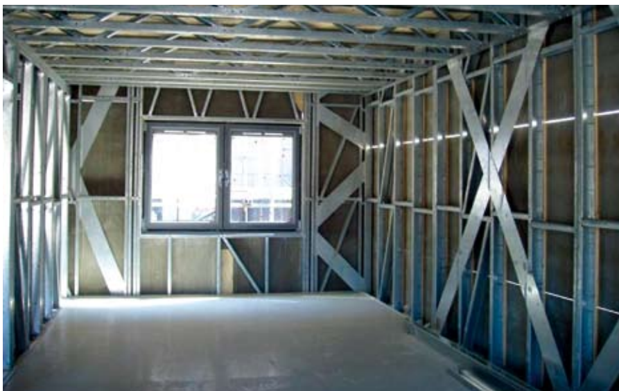
Abbildung 3.3 Leichte Fachwerkträger und Einsatz von zusätzlichem Estrich für weitgespannte Leichtbaudecken Metek Building Systems
