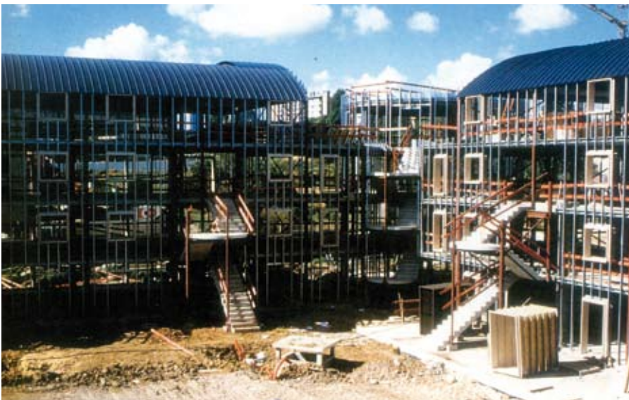
Abbildung 8.10 Das PRISM System im Bau: Primäre Stahlkonstruktion, Dach und Außenwände vor Montage der Fassade
