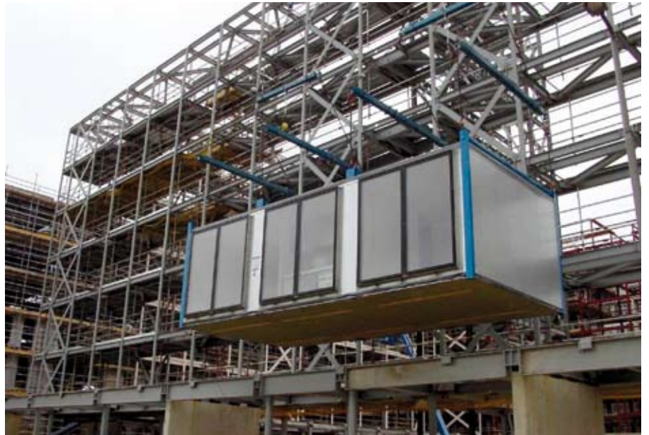
Abbildung 8.3 Tragendes Stahlskelett kombiniert mit verglasten Modulen, MOHO, Manchester Yorkon and Shed KM Architects
