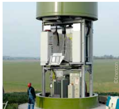
Abbildung 8: Transformator und Schaltgeräte
