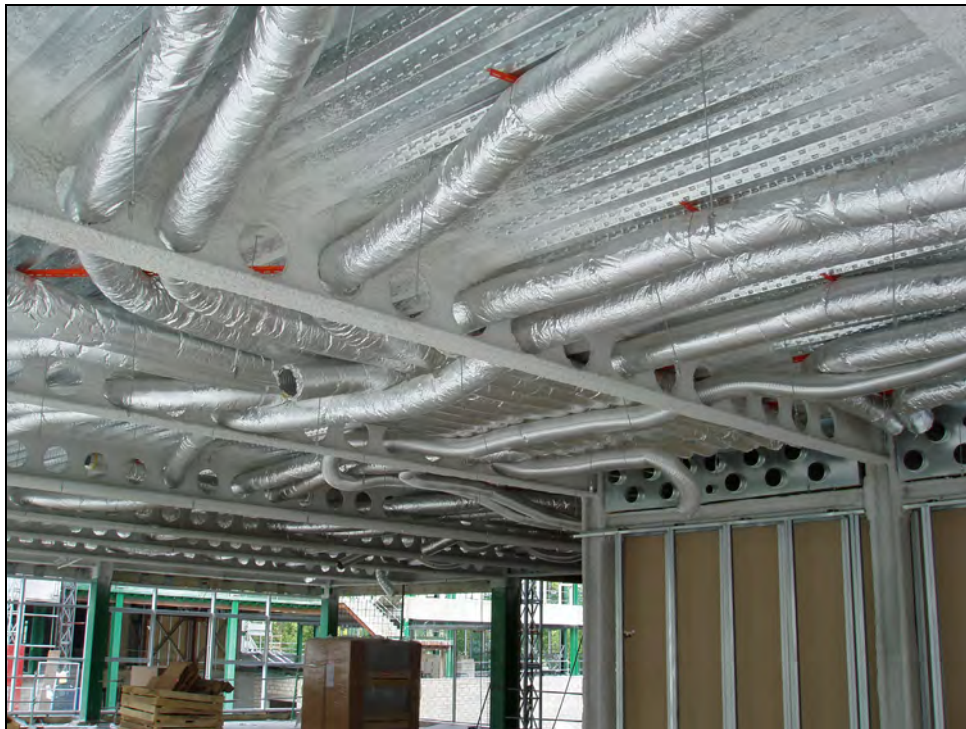
Rysunek 4.12 Belka ażurowa z wieloma przewodami instalacji technicznych
