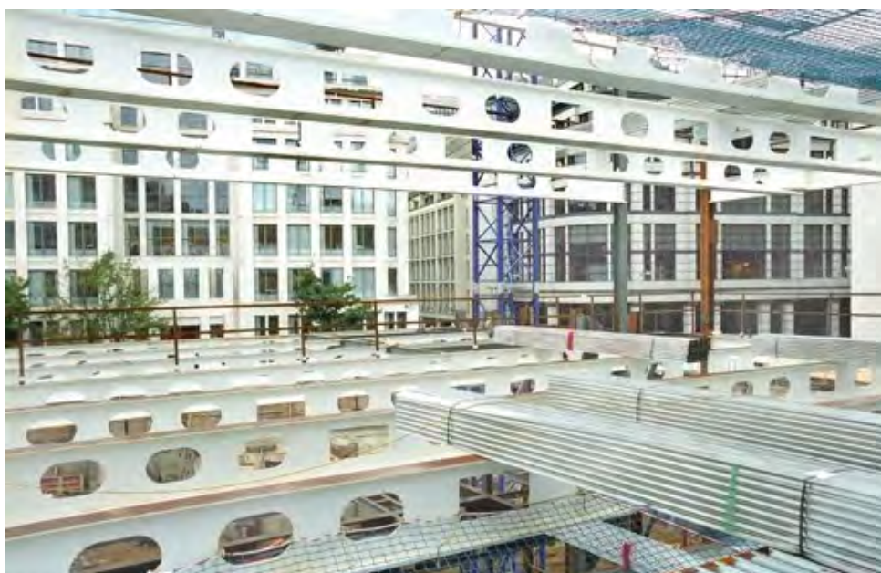
Rysunek 5.5 Belki o różnych rozmiarach otworów oraz osłoną przeciwpożarową przygotowaną poza miejscem budowy
