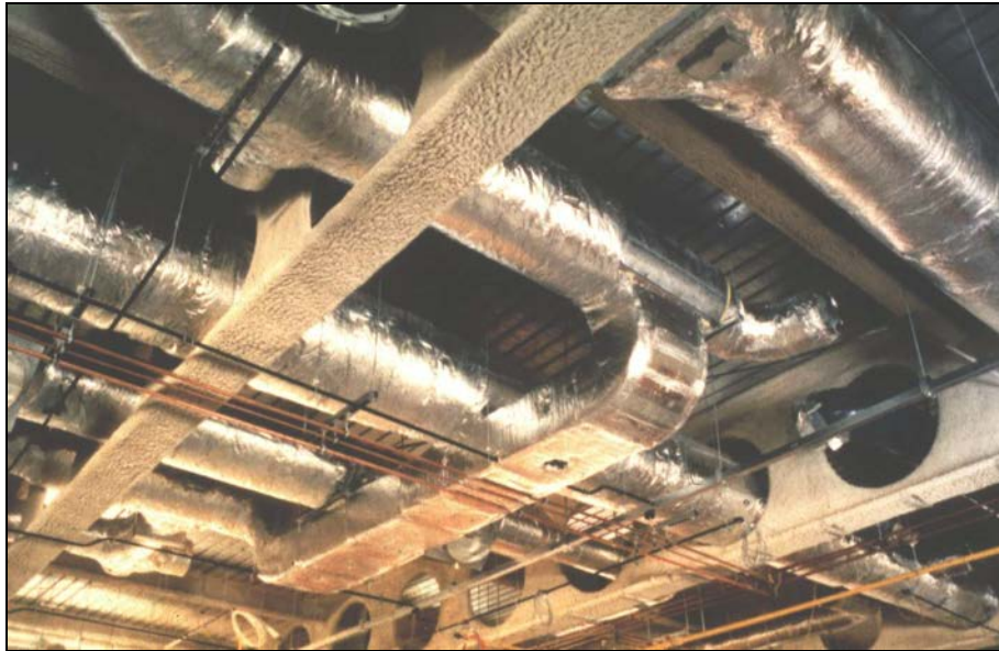
Figura 1.3 Instalaciones integradas en una viga alveolar
