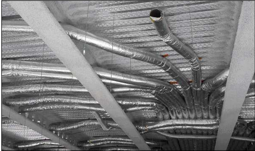
Figura 3.4 Conductos provenientes de la sala de máquinas principal, proporcionando un sistema ambiental controlado localmente
