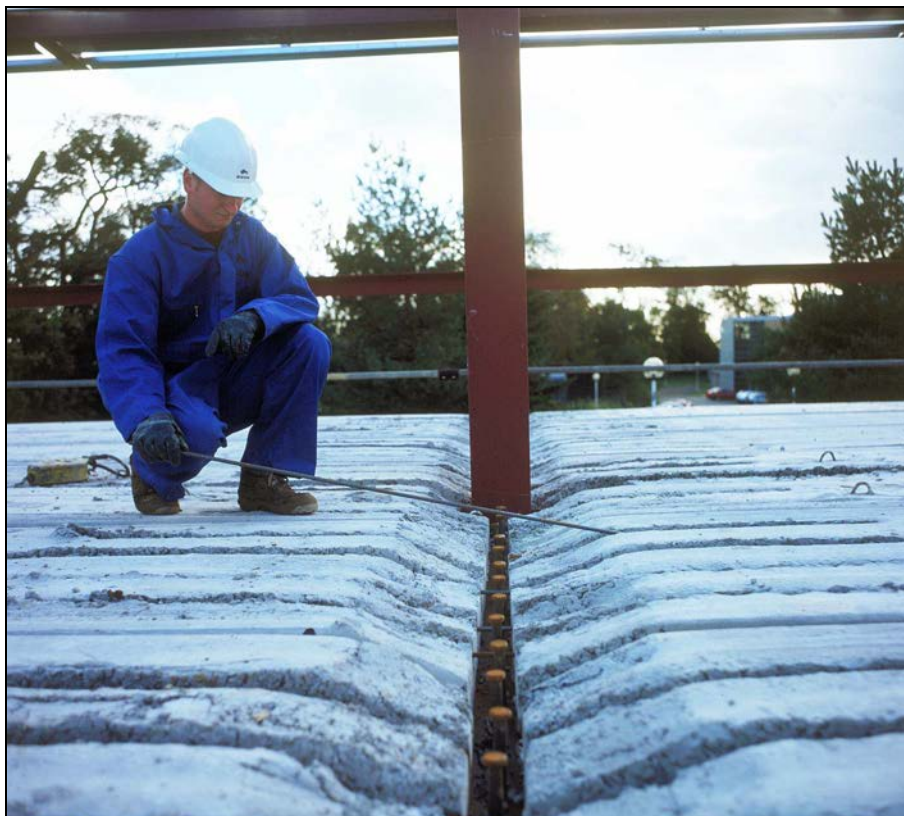
Figura 5.12 Construcción de forjado mixto con placas aligeradas de hormigón prefabricado, donde se puede observar la armadura transversal en las ranuras de las placas
