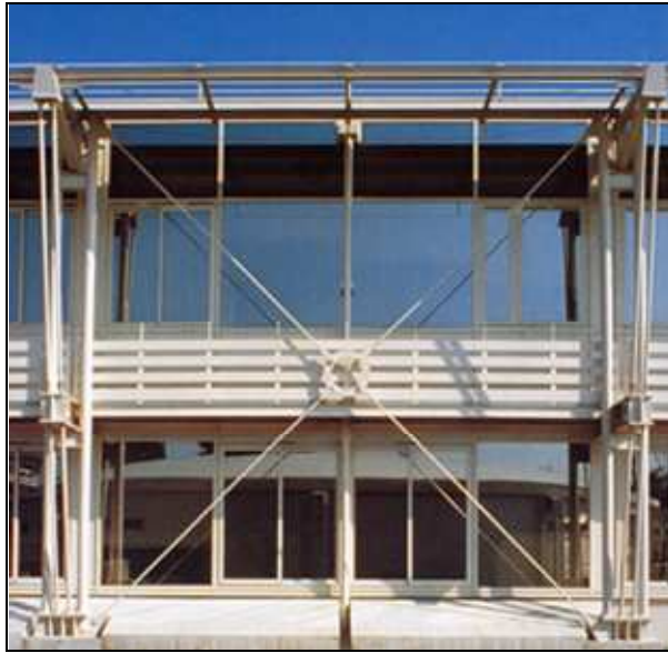
Figura 4.12 Arriostramiento con cruces de San Andrés externo en un edificio de varias plantas
