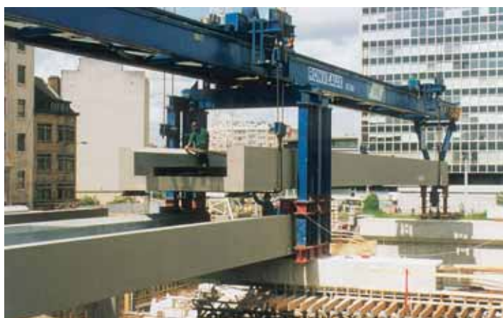
Extension de la gare de Bruxelles-Midi pour les trains Eurostar. - Mise en place rapide, à l'aide d'un portique, des tabliers préfabriqués à poutres latérales préfléchies et noyées dans le béton.
