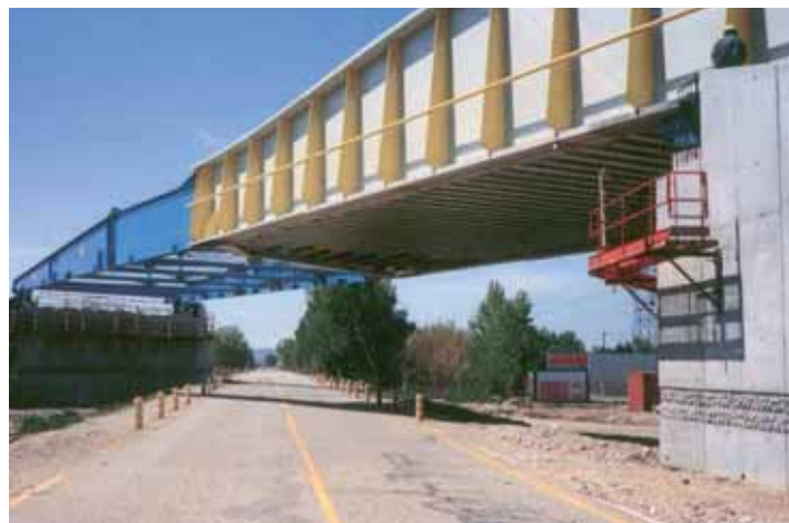
Cette photo représente le lancement d'un pont à poutres latérales de la LGV Méditerranée ouverte en 2002. Les semelles exposées des poutrelles enrobées transversales sont visibles en sous-face du tablier. La structure peinte en bleu, visible à gauche est l'avant-bec utilisé pour le lançage.
