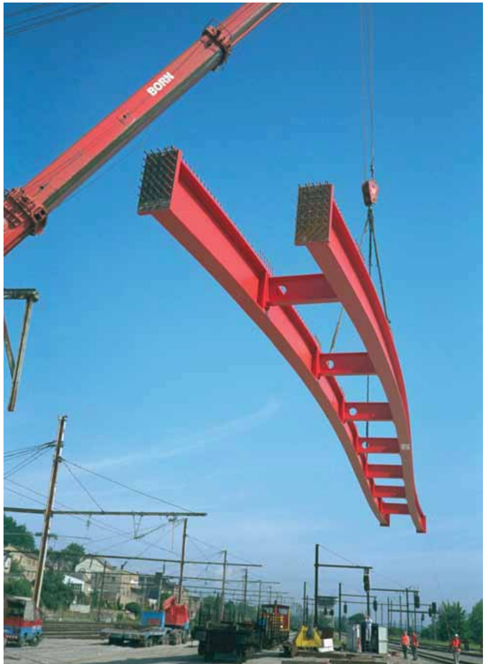
Pont routier à Differdange, Luxembourg - Montage à la grue de deux poutres maîtresses d'un pont mixte. Les poutrelles laminées ont été cintrées autour de leurs deux axes principaux afin de les adapter à la géométrie de la route portée.
