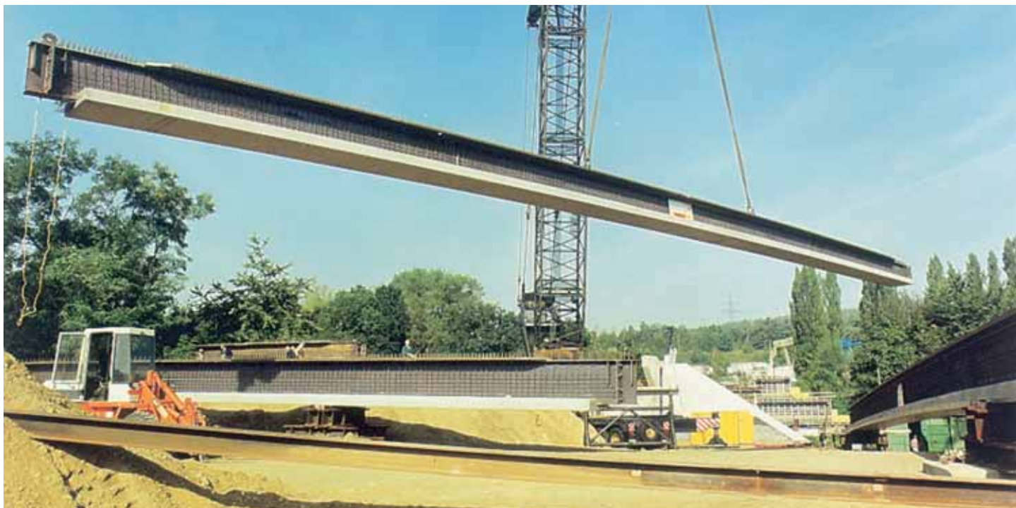
Construction d'un pont-route à une travée à Kerpen Horrem, Allemagne - Poutres mixtes préfléchies de type Préflex, à base de poutrelles laminées HEA 1000 de 41,25 m de longueur.
