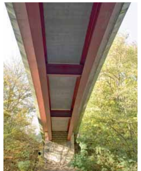
Vue de dessous des bi-poutres de la passerelle mixte à Wasserbillig, Luxembourg
