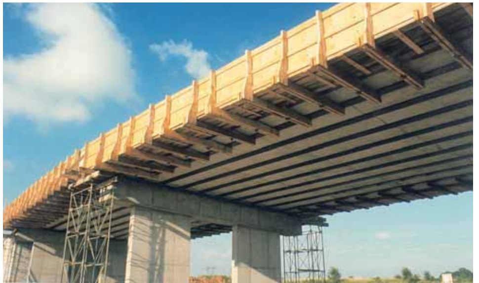
Construction d'un passage supérieur de l'autoroute A104, France. - Seul un étaieage au droit des piles est nécessaire. La perturbation de la circulation sur l'autoroute est ainsi minimale.
