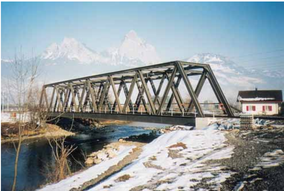
Nouveaux ponts-rails sur la Muota, ligne CFF du Gotthard, Suisse. - Les diagonales et les membrures supérieures sont des poutrelles laminées des séries HD et HE. Un acier thermomécanique a été utilisé en raison de ses bonnes propriétés de soudabilité.
