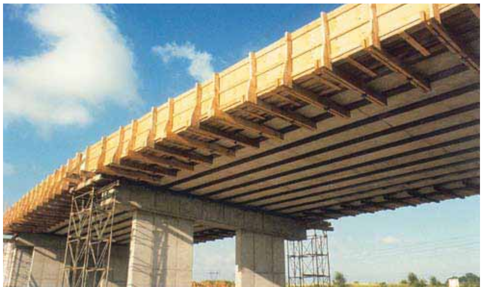
Bau einer Straßenüberquerung der Autobahn A 104, Frankreich. – Ein Lehrgerüst ist nicht notwendig. Die Verkehrsbehinderung auf der A 104 ist gering
