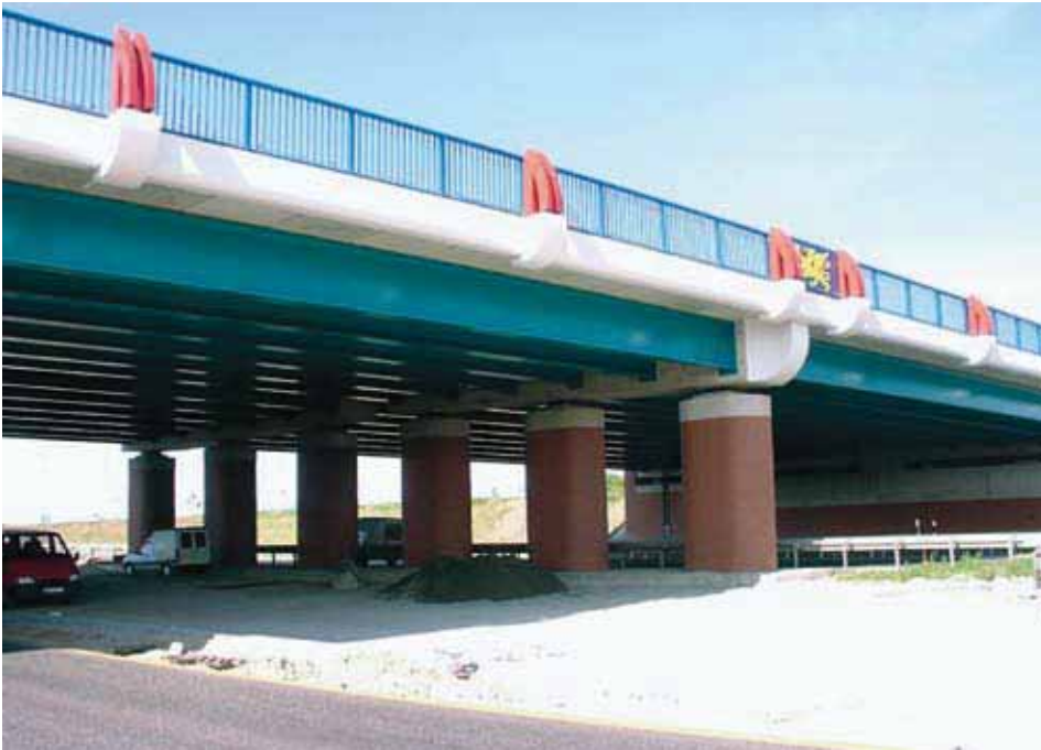
Verbundbrücke mit Betonquerträgern bei Bentwisch, Deutschland. – Form, Farbe und Detail prägen das Gesamtbild.
