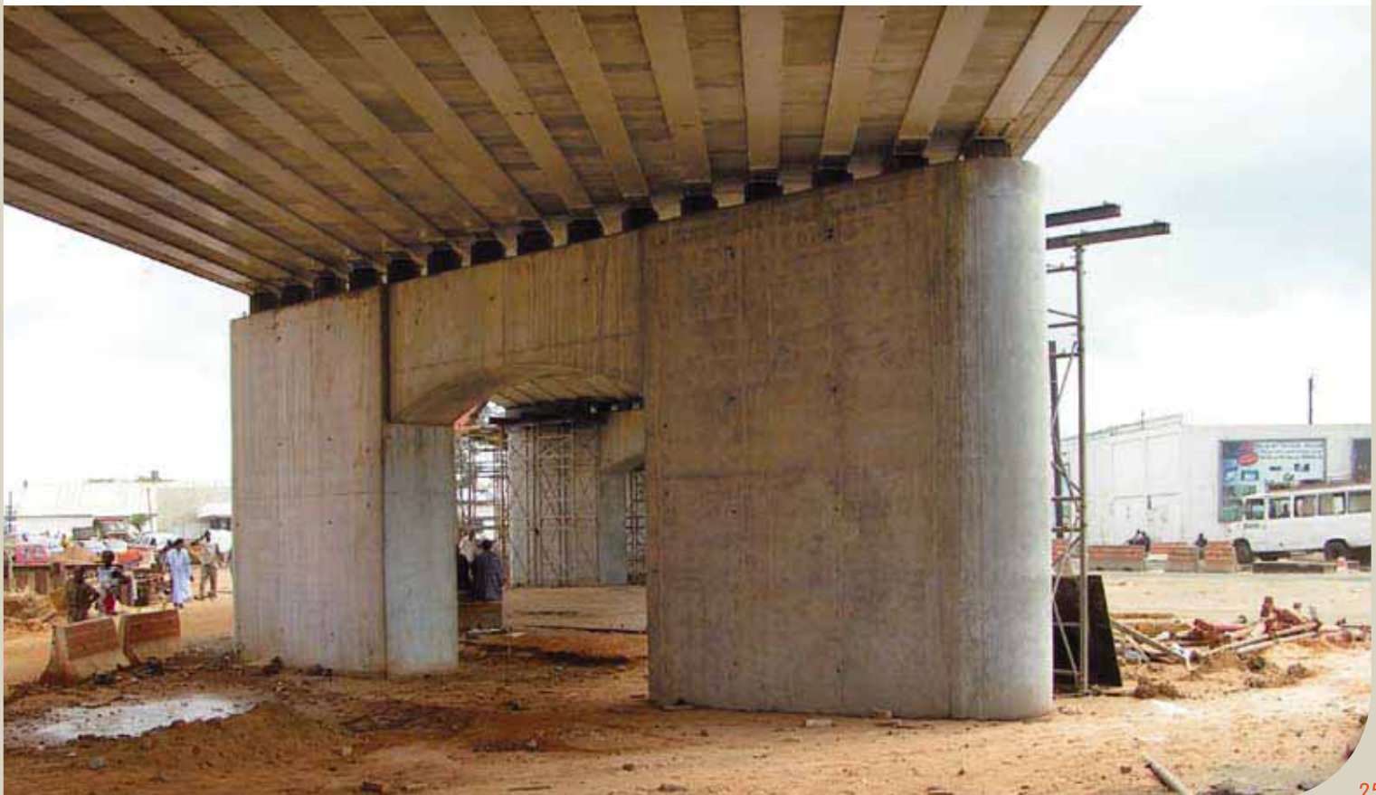
WIB-Brücke Pont de Cyrnos im Senegal. – Unteransicht des WIB-Überbaus und Sicht auf die Auflagersituation der Längsträger
