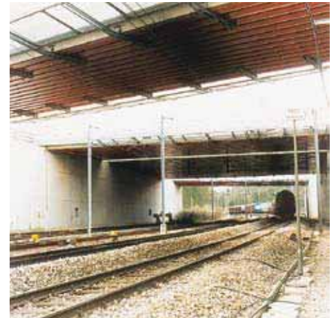
WIB – Überbau einer verkehrsreichen Eisenbahnstrecke.- Dank einer hochwertigen Oberflächenbehandlung sind die Unterflansche dauerhaft geschützt.
