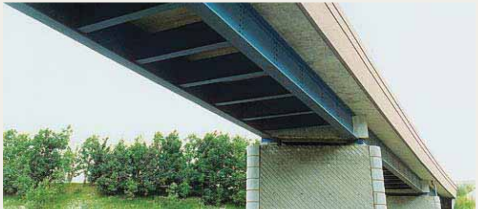
Eisenbahnbrücke über die Autobahn A23 in Fretin, Frankreich. - Vierfeld-Verbundüberbau mit Stützweiten von 16,9 - 21,9 - 23,0 - 17,8 Metern. Die zwei durchlaufenden Hauptträger und die Querträger im Feld sind Walzträger; die Querträger über den Auflagern sind als Stahlbetonquerträger ausgeführt.
