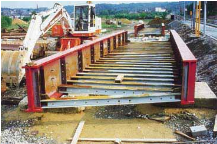
Eisenbahnbrücke über die Emile Mark Straße in Differdingen, Luxemburg. – Der Austausch des alten Brückenüberbaus mit direkter Schienenauflagerung durch eine Fahrbahn mit Schotterbett führt zu einer starken Bauhöhenbeschränkung und der damit verbundenen Wahl von Trogquerschnitten. Das Bild zeigt die neben den Gleisen vormontierte Stahlkonstruktion vor dem Betonieren des Troges.
