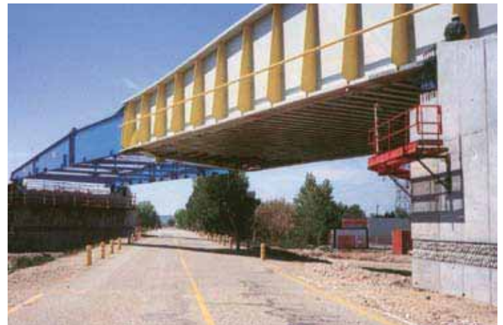
Einschub eines Trogquerschnitts für Brücke der LGV Méditerranée Hochgeschwindigkeitsbahnstrecke, Frankreich, welche 2002 in Betrieb genommen wurde. Die Flansche der Walzträger in Beton sind auf der Unterseite des Überbaus erkennbar. Die Vorschubschnabel der Konstruktion ist durch den blauen Anstrich vom Überbau farblich abgesetzt.
