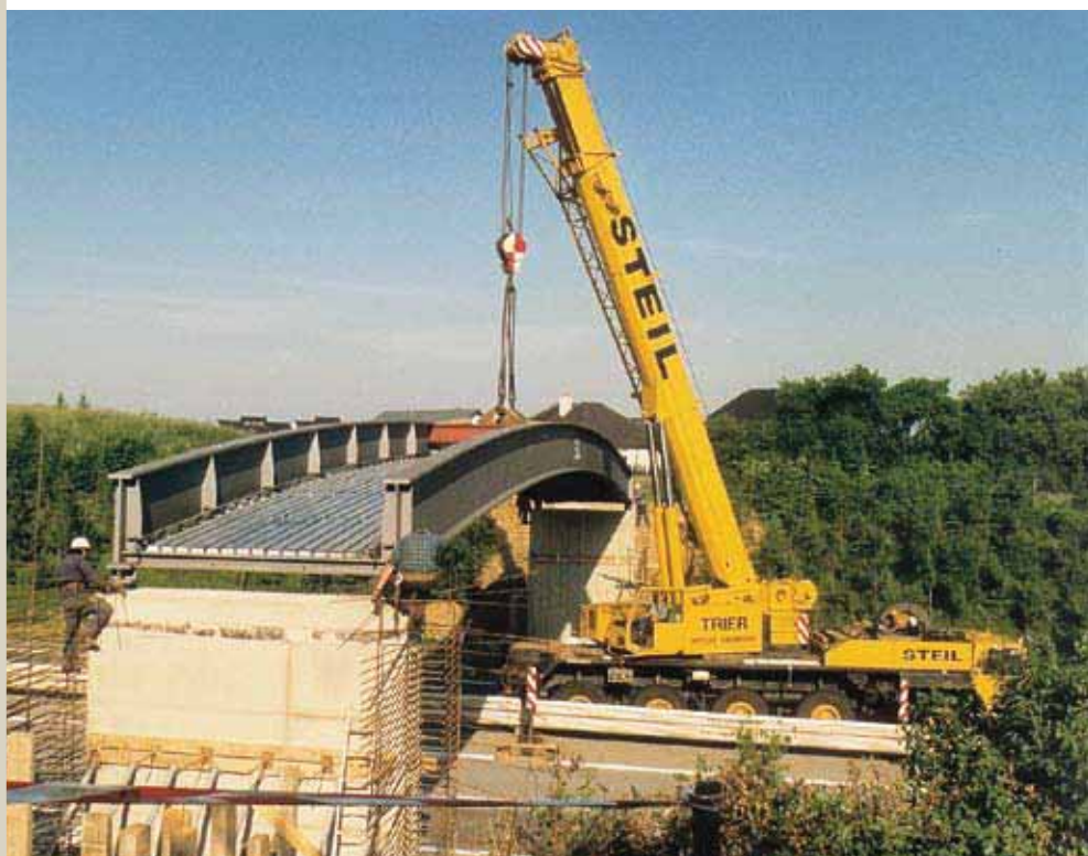
Montage einer Fußgängerbrücke mit abgesenkter Gehwegplatte. – Das vormontierte Tragwerk mit der befestigten Trapezblechschalung wird von einem Autokran eingehoben.
