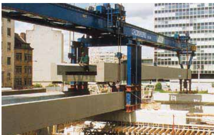
Ausbau des Bahnhofs Brüssel - Süd für die Eurostar Züge. – Schnelle Montage mit Hilfe einer Einschubvorrichtung der vorgefertigten Trogüberbauten aus vorgespannten einbetonierten Walzträgern.
