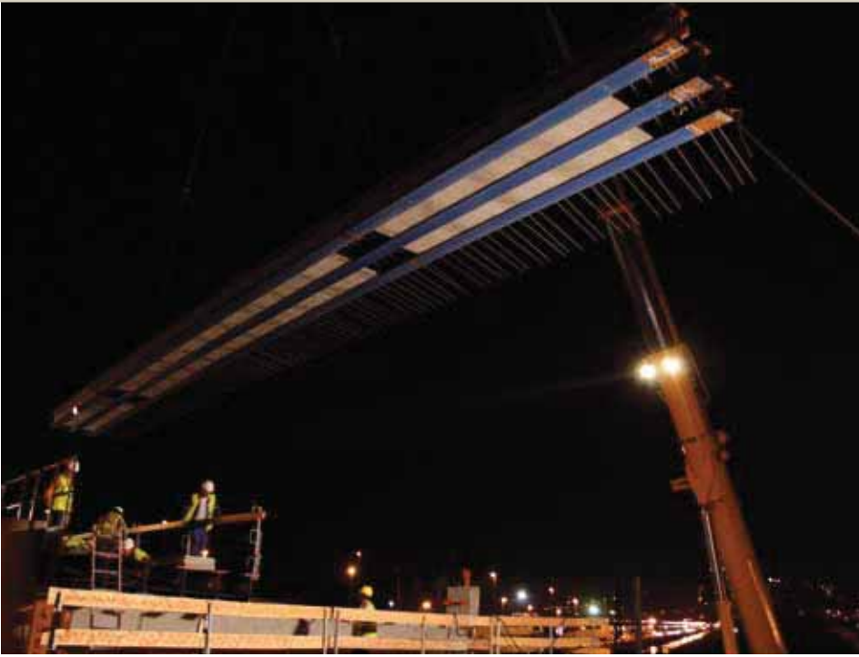
Straßenbrücke bei Sète-Frontignan, Frankreich. – Einhub eines WIB-Brückenelements über die Gleise der zu querenden Bahntrassen.
